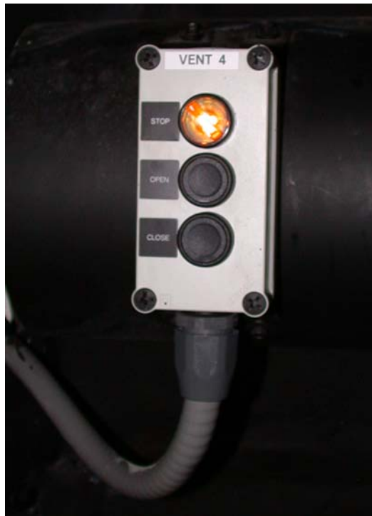
Manual Vent Door Controls
